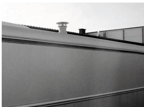
Fig. 84: Camino di scarico del riscaldamento a gas
