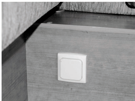
Fig. 70: Presa elettrica 230 V, esempio
