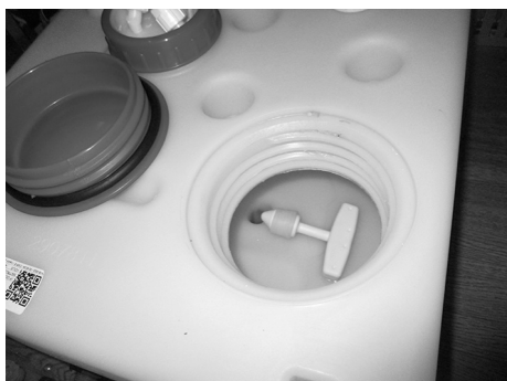
Fig. 99: Tappo di scarico del serbatoio dell'acqua fresca
