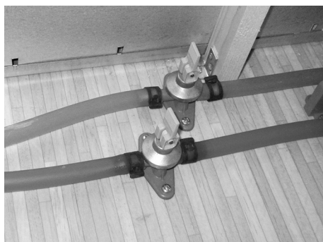
Fig. 104: Valvole di scarico aperte
