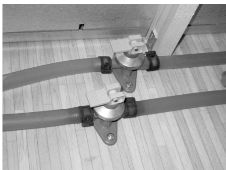
Fig. 178: Valvole di scarico chiuse
