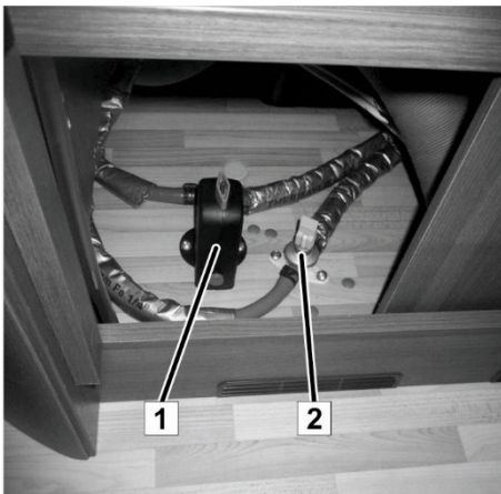
Fig. 110: Valvole di scarico Riscaldamento TRUMA Combi
