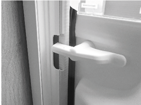
Kuva 28: Ovi on jaettu, puitteet lukossa
